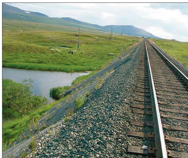
Рис. 1. Скопление воды у подошвы земляного полотна [Ашпиз, 2014].
